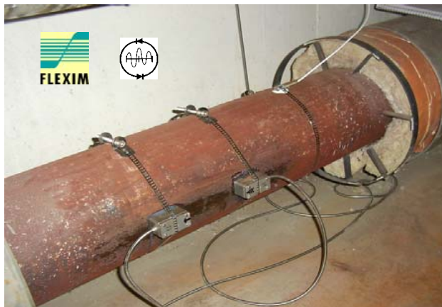
Die beiden Messköpfe des Durchfluss-Sensors Typ M und der Pt100-Rücklauf-Temperaturfühler an einem Rohr DN 200
